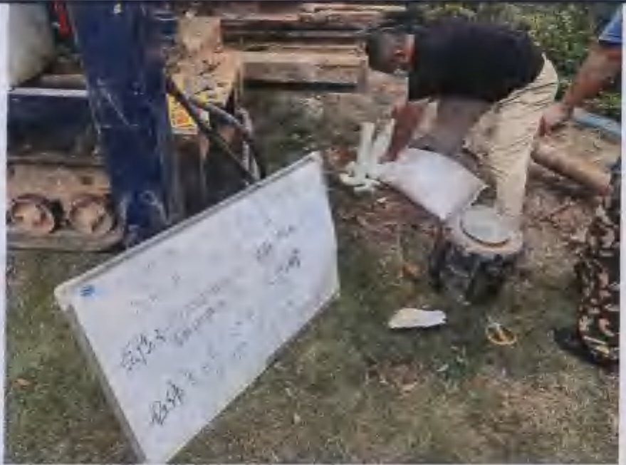
T10 监测井安装照片
